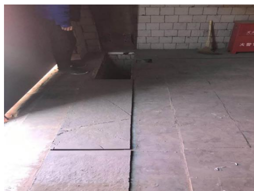
危险废物仓库防渗措施
