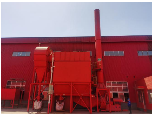
熔炼系统除尘器及排气筒
