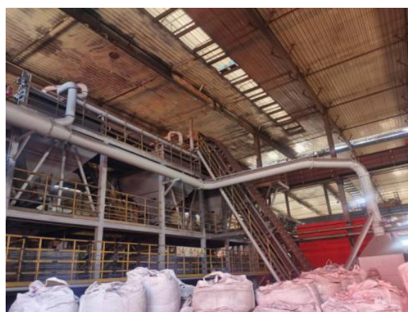
进料口集气罩以及下料口除尘设施串联线路
