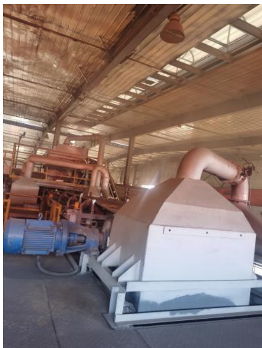
全封闭式下料口配套集气罩
