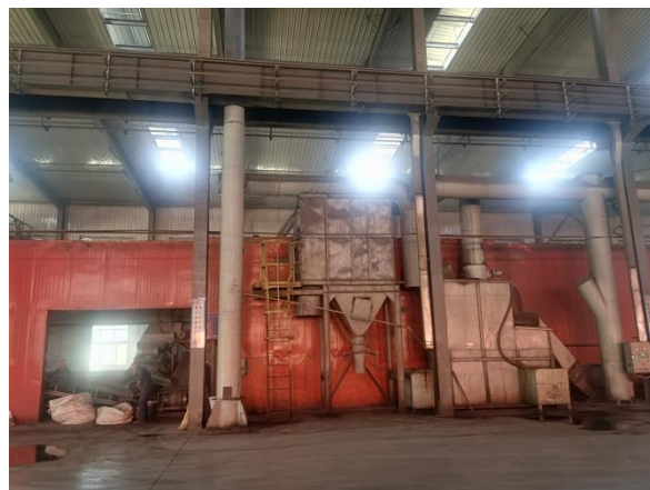
破碎系统除尘器及排气筒
