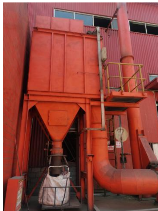
上料系统除尘器及排气筒
